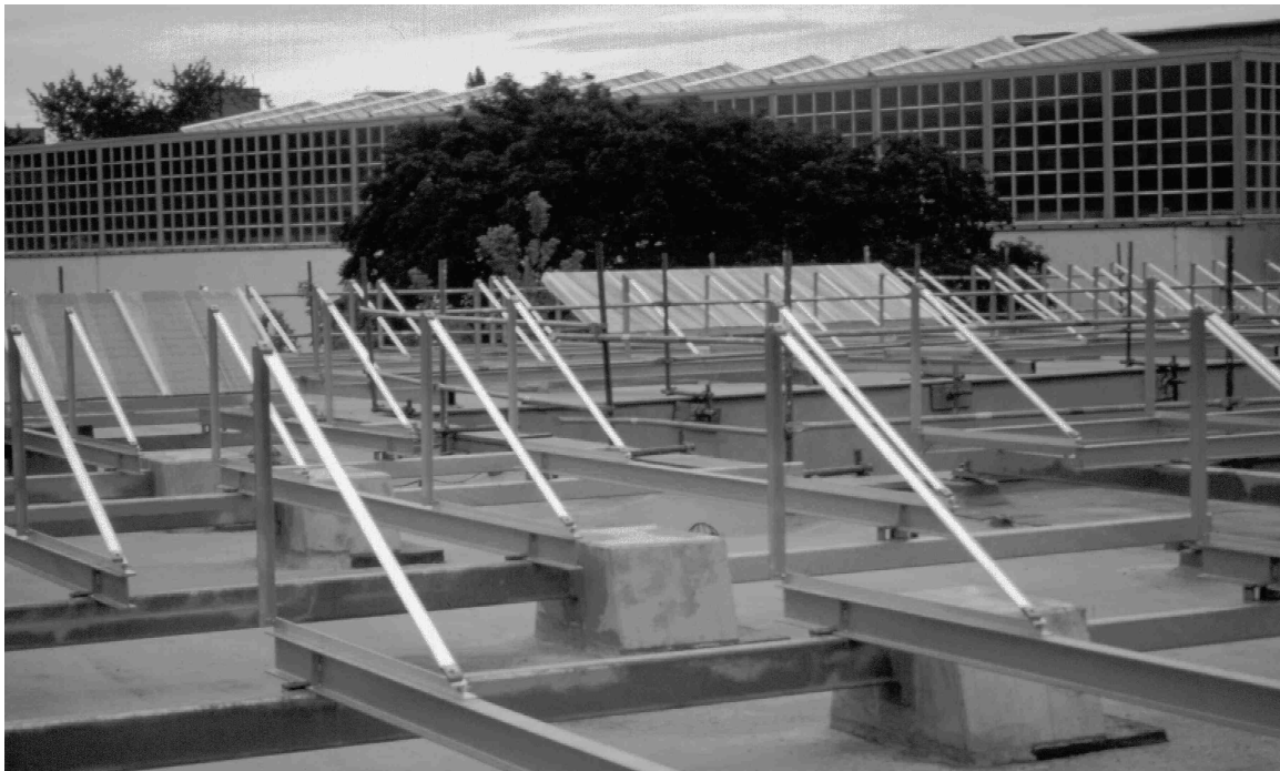
Abbildung 5: Flachdachaufständerung mit beschwerenden Elementen, solar unterstütztes Brauchwassererwärmung Stadtbad Chemnitz, 289 m 2 Kollektorfläche, Versorgung des 22000 l Warmwasserspeichers (Hochspeicher) und des 25 m und 50 m Schwimmbeckens (Schwallwasser), kein separater Solarspeicher notwendig, Beschränkung der Kollektorfläche aus Denkmalschutzgründen
