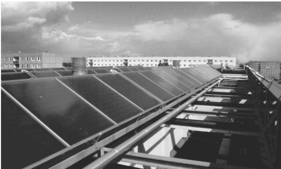
Abbildung 4: Flachdachaufständigung, solar unterstützte Brauchwassererwärmung (Vorwärmanlage), Studentenwohnheim „Joh.-R.-Becher“ in Leipzig, 398 m 2
