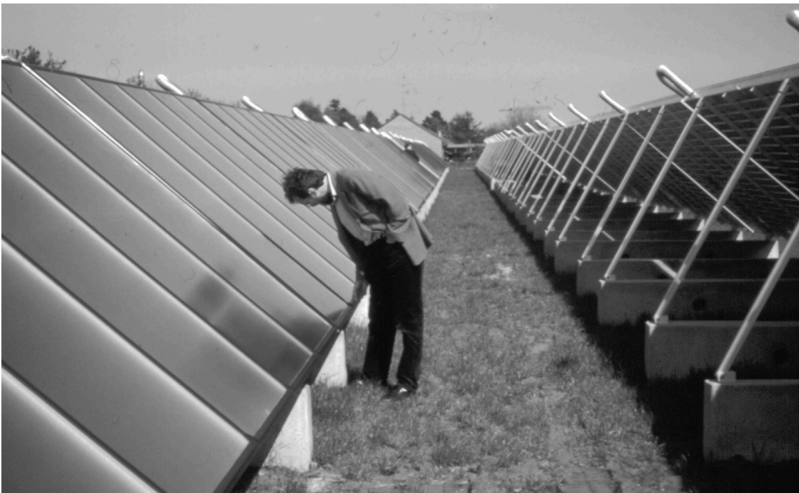
Abbildung 8: Freilandaufständerung, solar unterstütztes Nahwärmesystem Marstall (Dänemark), 8000 m 2 Kollektorfläche (Anlage befindet sich im Ausbau), 2100 m 3 oberirdischer Heißwasser-Speicher, 1997, Einbindung in Nahwärmeversorgung von Marstall
