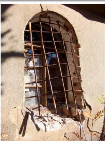
Einbruchspuren 2005 an der Kirche in Přebuz/Frühbuß
