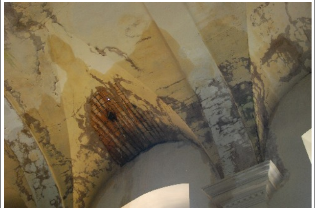
Daraus folgende Schäden im Kirchenschiff
