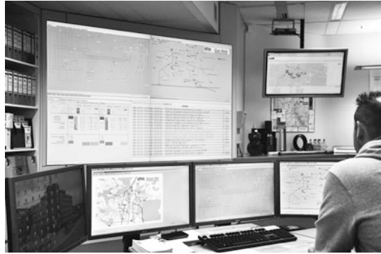
Abb. 8.29 Querverbundwarte der Erlanger Stadtwerke mit LED-Rückwärtsprojektion (Erlanger Stadtwerke AG)
