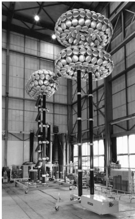
Abb. 6.6 Hochspannungsprüffeld mit Greinacherkaskade ( links ) und Spannungsteiler ( rechts ) (Haefely Trench AG, Basel)
