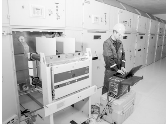
Abb. 5.3 Geschottete Mittelspannungsanlage 20 kV. Prüfung eines Vakuumleistungsschalters in Einschubtechnik auf Montagewagen (OMICRON electronics GmbH)
