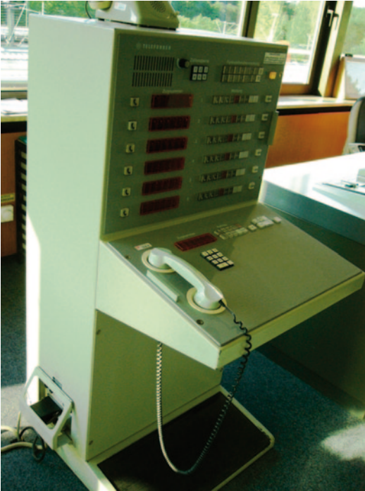
Abb. 17.17 Zugfunk 70-Zentrale der Fa. Telefunken (AEG)
