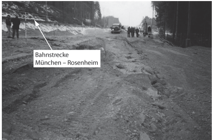
Abb. 4.113 Bahnkörperverbreiterung im Moor Zorneding/Kirchseon. Grundbruch Januar 1999 – Abrisse und starke Senken im Planum und in der Böschung klaffende Risse im neu geschütteten Bahnkörper, Herabsetzung der Geschwindigkeit auf der Fernbahnstrecke auf V_B \leq 30 km/h wegen Gleisverformungen
