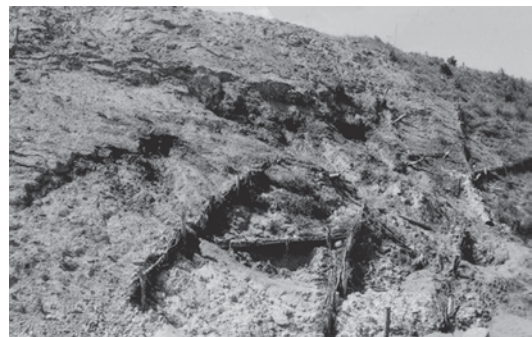
Abb. 4.40 Fehlgeschlagene Böschungssanierung mit Totfaschinen im Geschiebemergel
