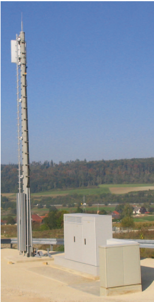
Abb. 15.5 Sendeanlage einer GSM-R-Station
