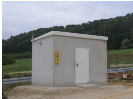
Abb. 15.8 Betonschalhaus für BOS-Funk mit Außenantenne zur Freiraumversorgung am Tunnelportal
