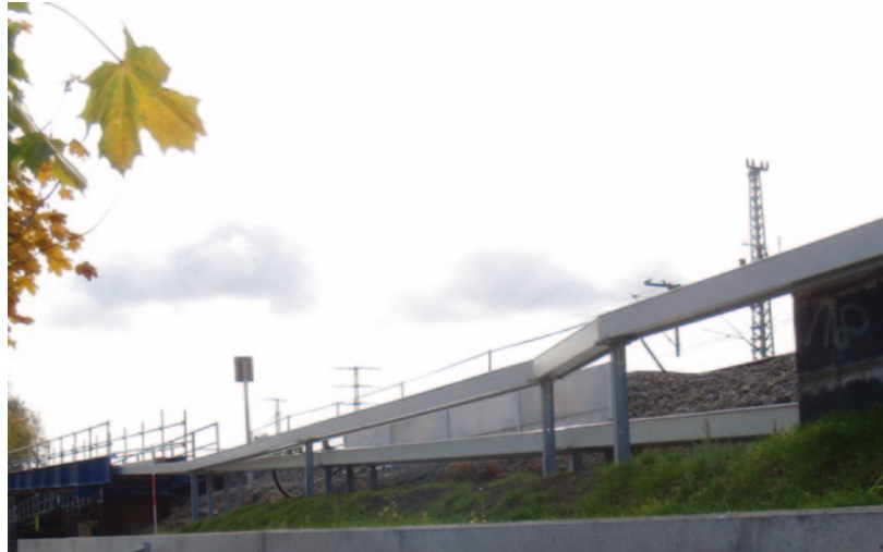
Abb. 16.18 Aufgeständertes Kabelkanalsystem (Stelzentrog)
