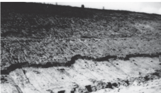
Abb. 4.38 Austritt der Sickerlinie in der Böschungsfäche
