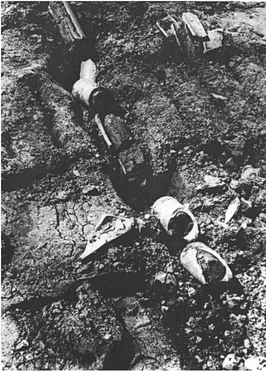
Abb. 4.60 Versetzte Tonrohre einer Drainage – nicht gelöstes Filterproblem an den Fugen
