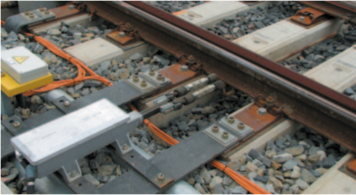
Abb. 10.16 Zungenprüfkontakt an einer Weiche
