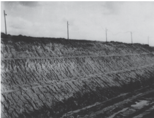
Abb. 4.34 Punktuelle Erosion einer Rohböschung am Tiefpunkt einer Berme
