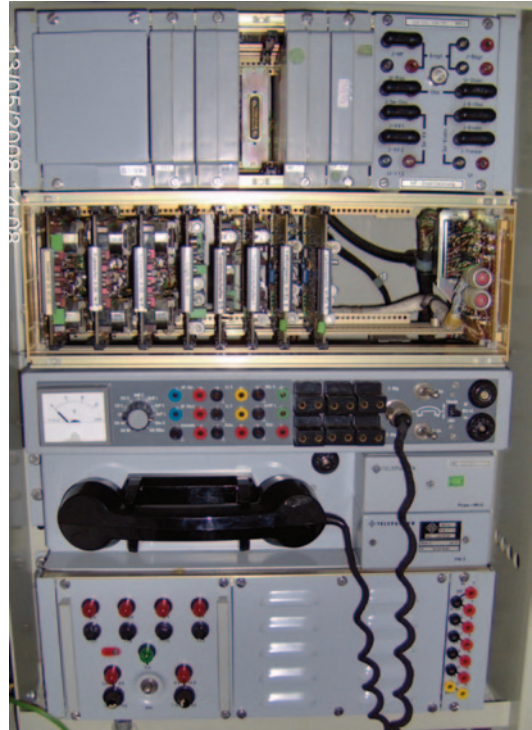
Abb. 17.18 Ortsfeste Sende- und Empfangsanlage der Fa. Telefunken für analogen Zugfunk (70er-Jahre)
