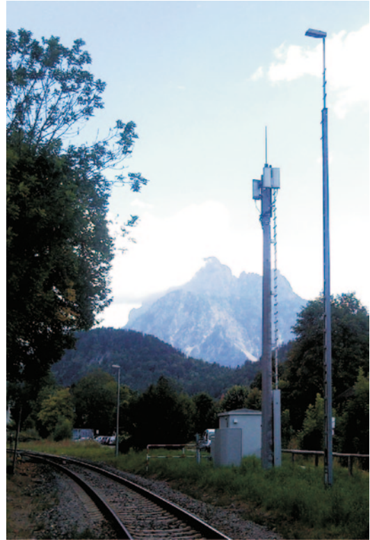
Abb. 17.6 GSM-R-Senderstandort an einer Bahnstrecke
