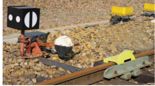
Abb. 10.20 Ortsbediente Gleissperre mit Gleissperrensignal
