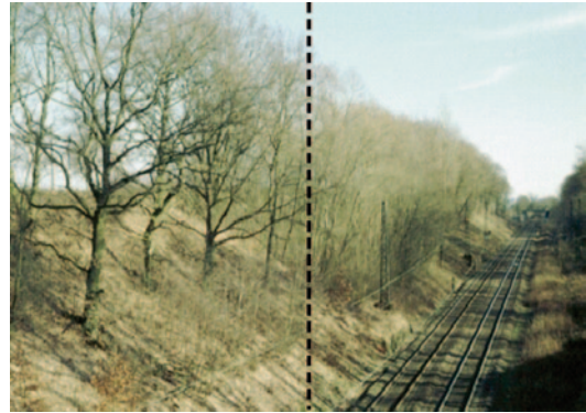
Abb. 19.12 Beispiel für das Leitbild „Mittelwaldartige Bestände“. In der rechten Bildhälfte ist die ungünstige Ausgangslage erkennbar. Durchgewachsene Stockausschläge unterschreiten die Abstände zur Oberleitung. Der dichte Aufwuchs führt zu schlechten H/D-Verhältnissen. In der linken Bildhälfte ist das Pflegeziel verwirklicht. Die stabilen Eichen mit ausgeglichenem Kronenhabitus und gutem H/D-Verhältnis sind freigestellt. Die Stockausschläge sind zurückgeschnitten
