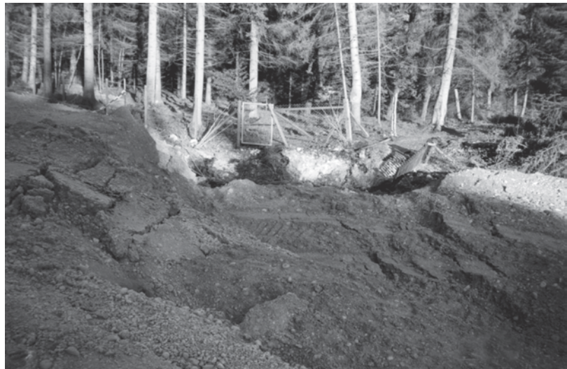
Abb. 4.112 Bahnkörperverbreiterung im Moor Zorneding/Kirchseon. Grundbruch Januar 1999 – Aufbrüche am neuen Dammfuß bis 2 m, Baumbewuchs angehoben und stürzt nach und nach um
