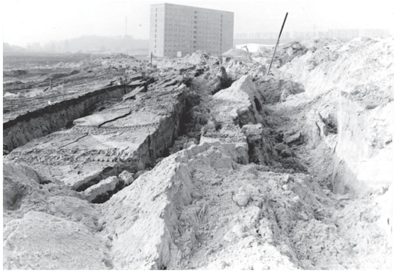
Abb. 4.96 Grundbruch einer Moorüberschüttung bei ca. 7 m erreichter Dammhöhe
