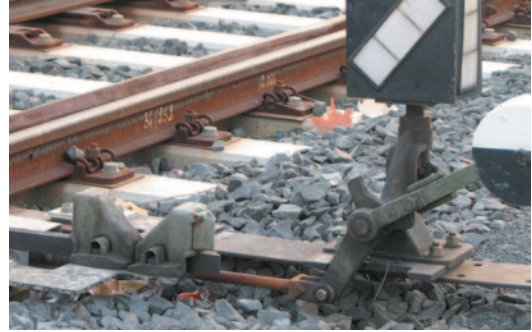
Abb. 10.18 Riegelhandschlösser an einer mechanisch ortsbedienten Weiche (je eines pro Stellung)
