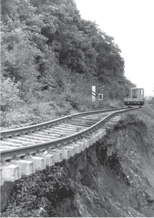
Abb. 4.2 Unterspülung des Bahnkörpers im Anschnitt, Gera 1981
