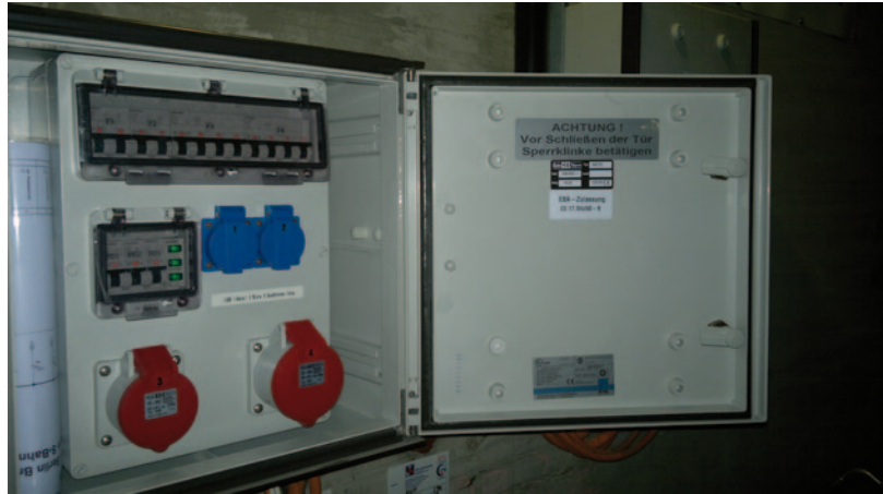
Abb. 15.7 Elektrant im Tunnel mit geöffneter Tür
