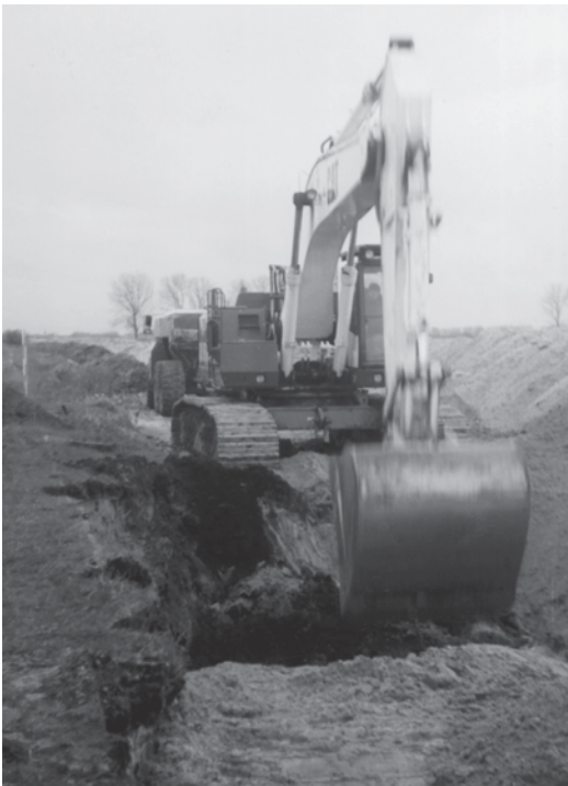
Abb. 4.83 Baggararbeiten am Dammfuß der zweigleisigen Strecke BAR 11/92 mit Sperrung des zugewandten Gleises
