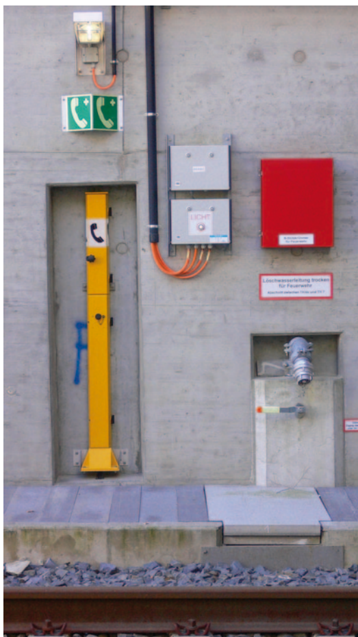
Abb. 17.40 Tunnelnotruffernsprecher am Randweg
