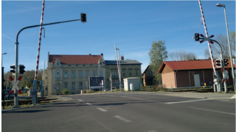
Abb. 15.6 Vollschranken- anlage mit Betonschaltheus und Gefahrenraumfreimel- deanlage
