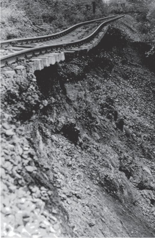
Abb. 4.41 Böschungsschaden durch Ausspülung infolge hydrostatischen Überdrucks
