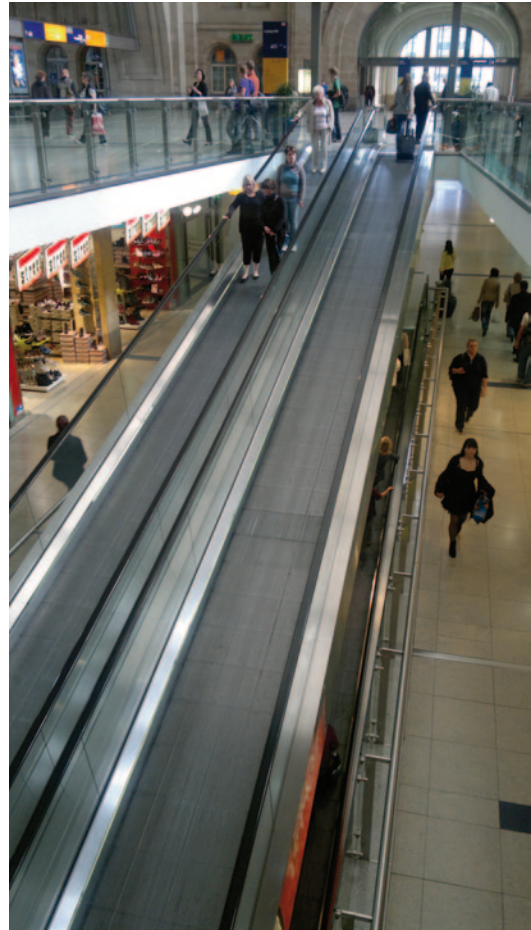
Abb. 15.19 Fahrsteig in einem Bahnhof, 3AC 230/400 V 50 Hz, ca. 2–5 kVA
