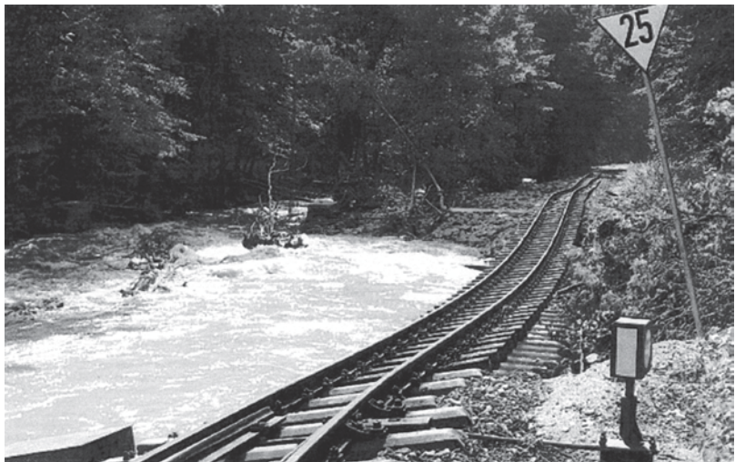
Abb. 4.54 Unterspülungen der Bahnanlagen im Rabenauer Grund. (2002 bei Dresden/Sachsen) (3)
