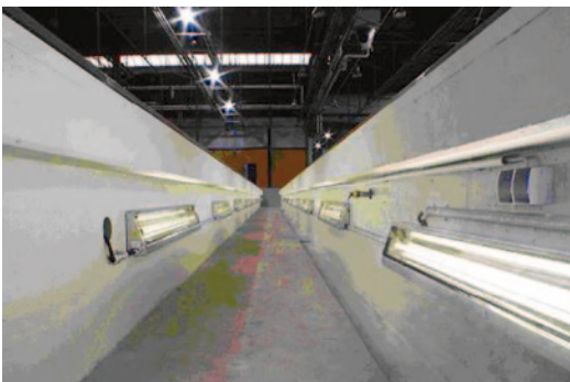
Abb. 15.29 Arbeitsgrubenbeleuchtung in einem Instandsetzungswerk der DB AG
