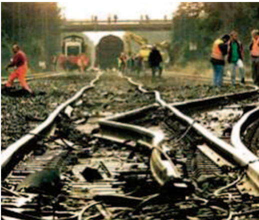
Abb. 17.36 Zerstörter Fahrweg nach Entgleisung
