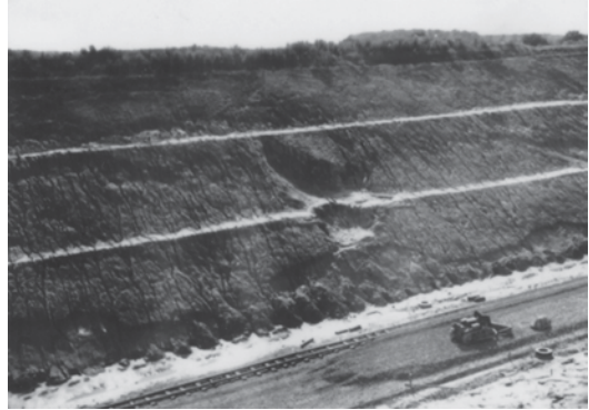
Abb. 4.35 Erosion nach Schmelzwasserkonzentration im Vorland und auf der Berme
