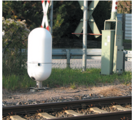
Abb. 10.8 Radarscanner an einem Bahnübergang
