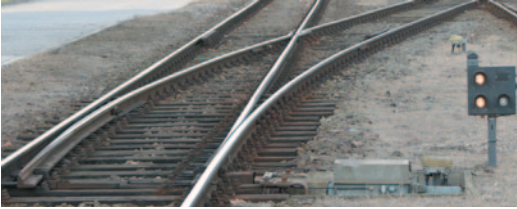
Abb. 10.17 Elektrisch ortsbediente Weiche mit Weichenlagemelder
