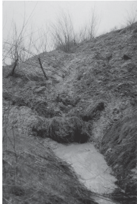
Abb. 4.39 Geschiebemergel in flüssiger Konsistenz nach der Frostperiode führte zum Abgleiten der bewachsenen Böschung einschl. Strauchbewuchs bei einer Böschungsneigung von 1:2
